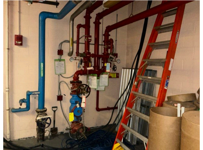
32 - FIRE SPRINKLER RISERS
